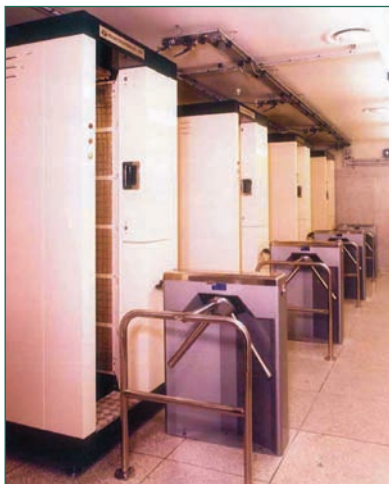
Pórticos de salida de zona controlada (detectores proporcionales de flujo de gas).
