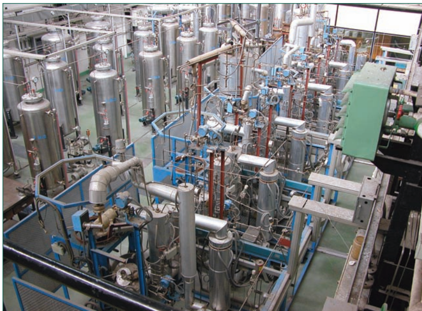
Figura 2. Foto de las instalaciones de Materiales, 1 Corrosión bajo tensión.
