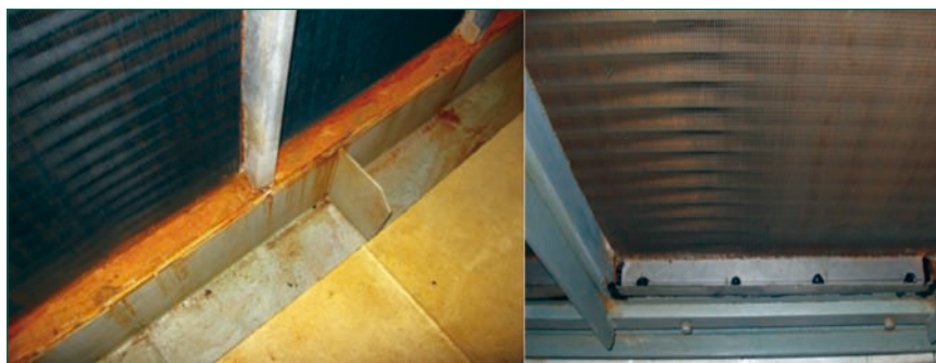
Figura 6. Estado interior de la base de los serpentines de las Unidades de Enfriamiento de la Contención, antes y después del saneado y limpieza.
