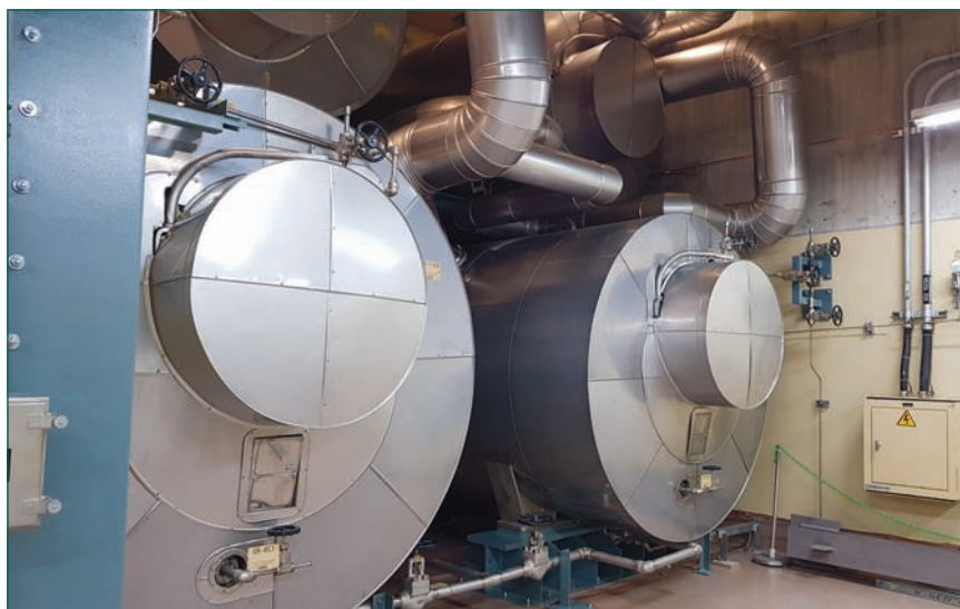
Figura 3. Venteo filtrado de contención.
